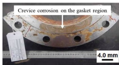
Gambar 3. Korosi Celah pada Flange (Kölblinger et al. 2022)
